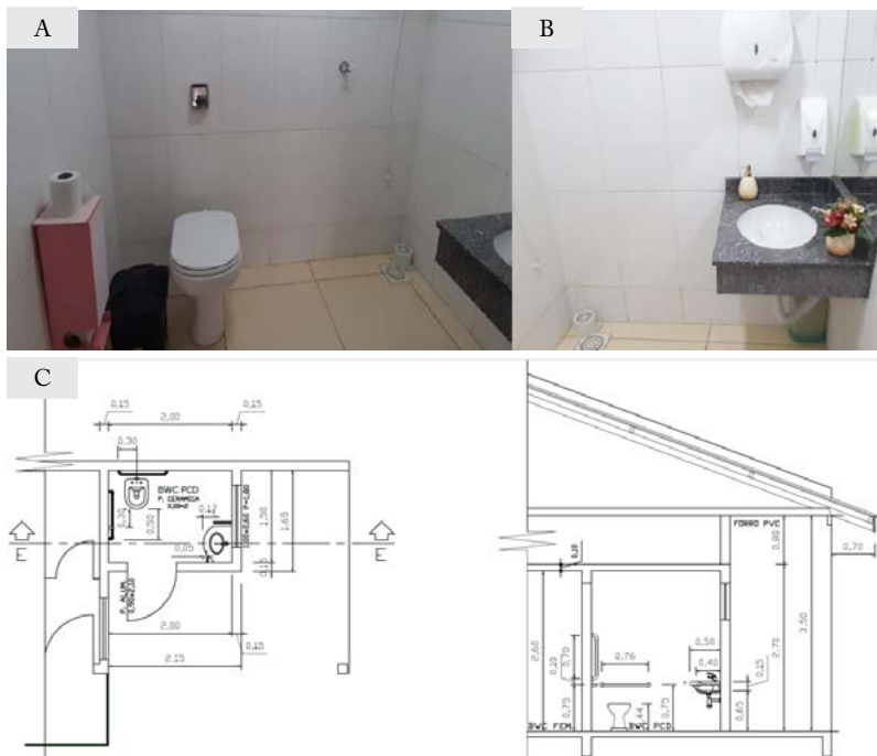
Figura 19 – a) sanitário sem a presenças das barras de apoio; b) lavatório sem fixações de ancoragem; c) proposta de adequação do banheiro. Fonte: Fotos registradas pelo autor (2022).
