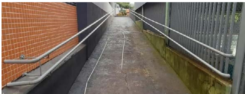
Figura 16: Corrimões sem a presença de anel de textura ou sinalização em braile. Fonte: Fotos registradas pelo autor (2022).
